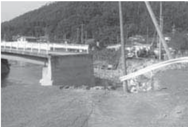
▲流れに削られて崩落した道路
