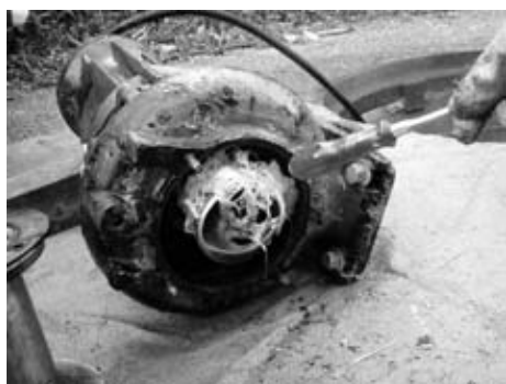
マンホールポンプに異物がつまった時の写真
