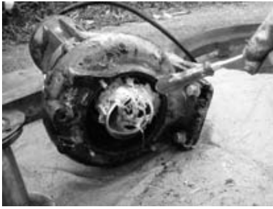
マンホールポンプに詰まった異物
