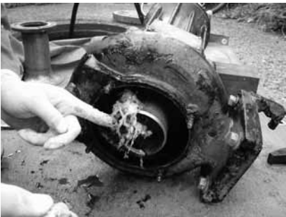
マンホールポンプに詰まった異物
