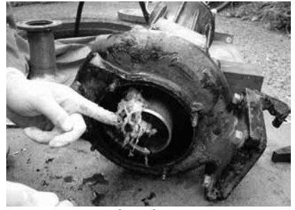
マンホールポンプに詰まった異物
