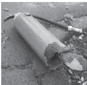
使用時に底部の腐食が原因で破裂した消火器
