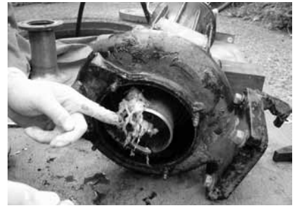
マンホールポンプに詰まった異物
