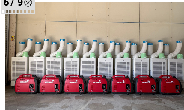
整備した発電機とスポットクーラー
