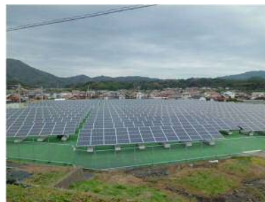
大朝太陽光発電所
