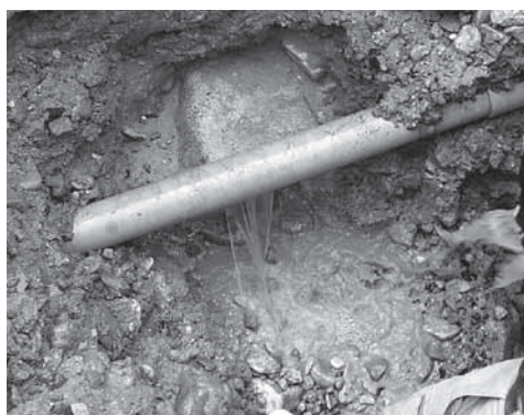
老朽化した水道管からの漏水
