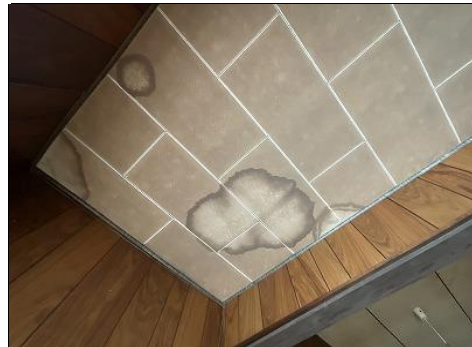
縁側天井雨漏りシミ
