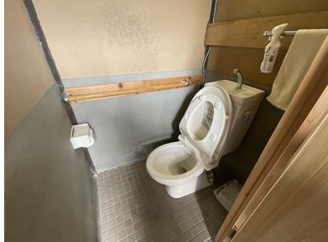
北東側トイレ 水洗
